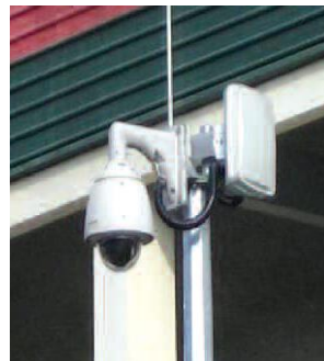
Gambarfoto 7.15 : Pemasangan kamera litar tertutup (CCTV) di bandar-bandar diharapkan dapat mengurangkan kadar jenayah yang berlaku.
